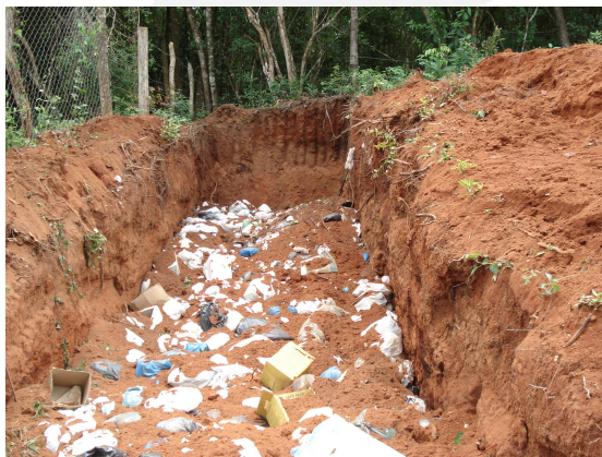
Foto 13 – Vala de Resíduos de Serviços de Saúde em operação.
