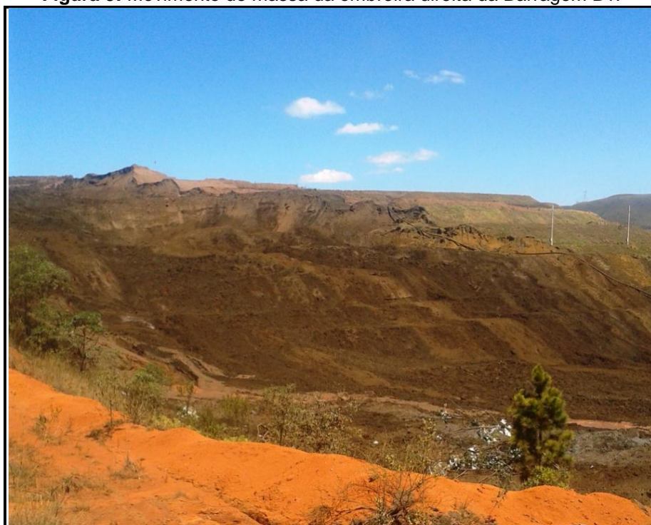
Figura 9: Movimento de massa da ombreira direita da Barragem B1.
