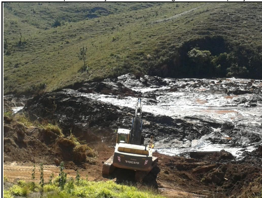
Figura 11: Escavadeira alocada para realização das obras emergenciais de recuperação da Barragem B3.
