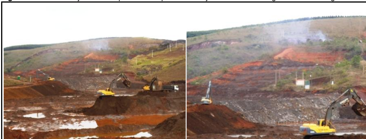
Figura 12: Movimentação das máquinas na etapa de realização das obras emergenciais da Barragem B3.
