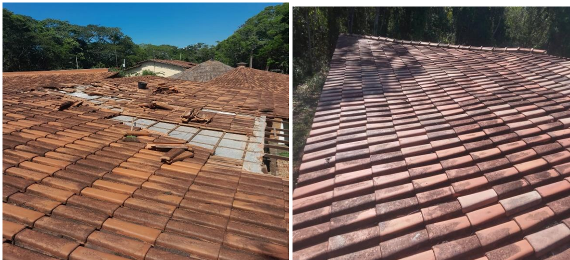
Figura 3. Centro de Treinamento: O telhado foi danificado devido à queda de uma árvore durante um evento climático adverso. A ruptura resultou em aberturas que expõem a estrutura a riscos de infiltração de água. O reparo imediato foi crucial para mitigar esses riscos, preservar a segurança e proteger a estrutura contra danos adicionais causados por condições climáticas futuras.
