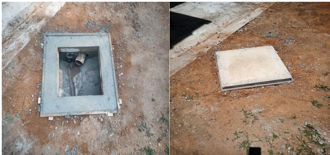
Figura 3. Casa das Flores: Manutenção dos sistemas de esgoto para prevenir entupimentos, vazamentos e danos ambientais.
