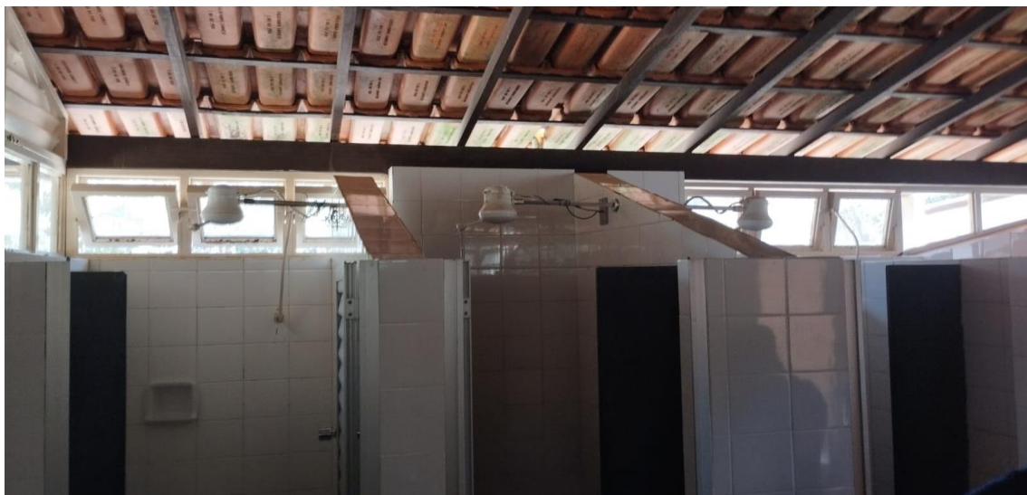
Figura 1. Banheiros (Camping): Substituições dos chuveiros elétrico devido ao mal funcionamento, segurança dos usuários e consumo energético.
