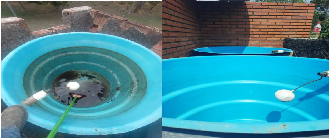
Figura 8. Armazenamento de água: foram realizadas limpezas regulares nas caixas d'água para garantir a qualidade da água consumida.
