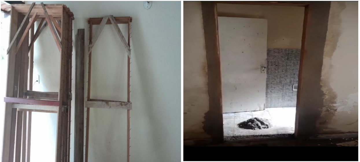
Figura 7. Casa das Flores: Substituições das aduelas e alizares, devido aos desgastes naturais, danos causados por umidade, cupins, as trocas foram cruciais para a qualidade e a aparência das portas e garantindo um ambiente seguro e bem conservado.
