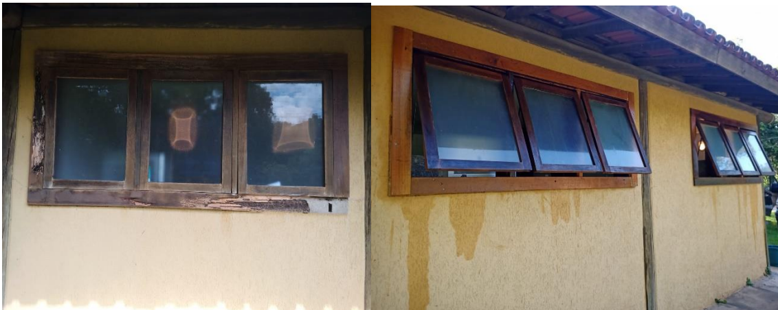
Figura 12. Centro integrado Macuco: Substituições do entorno da estrutura que havia sido comprometida por cupins.
