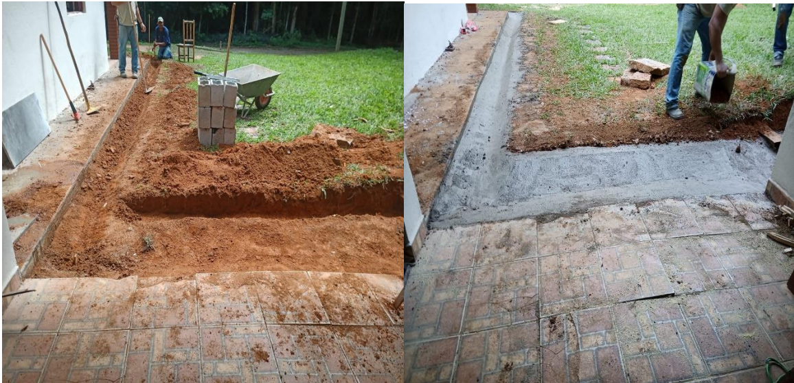
Figura 13. Casa das Flores: Finalizada todas as manutenções com concreto armado nas sarjetas no entorno prevenindo contra possíveis danos causados pela água.
