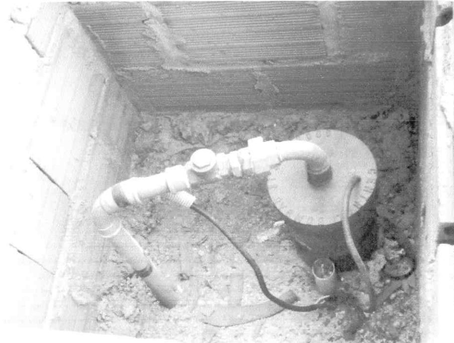
Detalhe da captação no poço e da tubulação de recepção na caixa protetora do poço.
