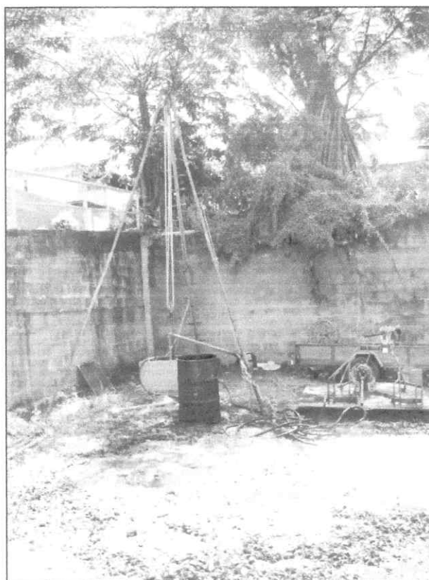
Foto mostrando os equipamentos instalados para o teste de vazão.
