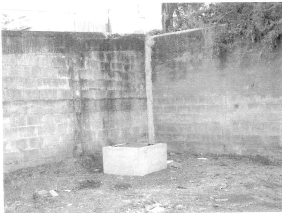
Vista da Caixa Protetora do poço localizada no canto SW da propriedade.
