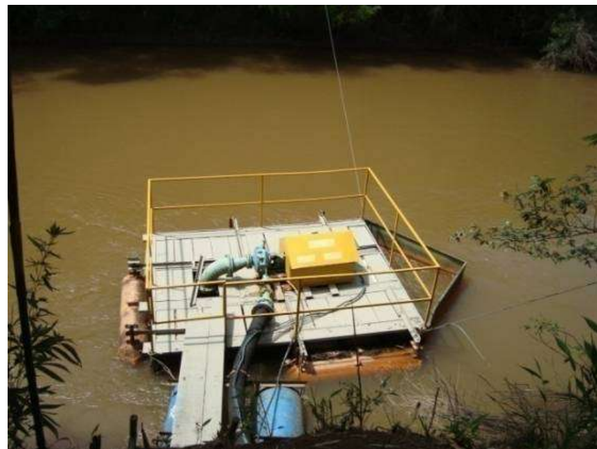
Detalhe para a balsa de captação para abastecimento doméstico da sede de São Vicente de Minas (rio Aiuruoca).
