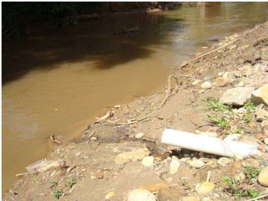
Ponto de lançamento de esgoto bruto da sede municipal de Alagoa.
