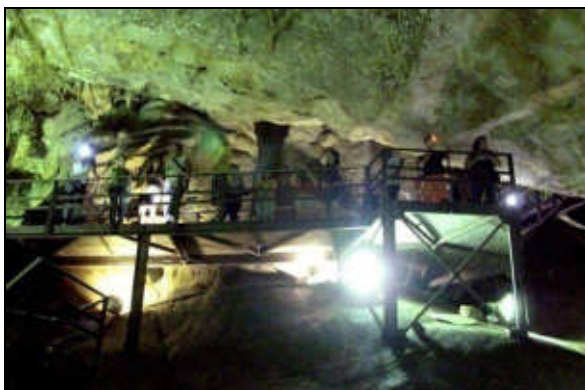
A – Exemplo de refletores mal direcionados, iluminando a estrutura da passarela, enfatizando e aumentando o impacto visual desta e causando ofuscamento nos visitantes. Foto: V. Moura.
