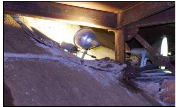
D – Eletroduto e luminárias instaladas sobre espeleotema. Neste local, os eletrodutos e luminárias poderiam ter sido fixados sob a passarela. Local: próximo ao Lago Suspenso. Foto: L. Alt.
