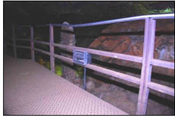
B – Trecho da passarela, no Salão das Raridades, com corrimão danificado por corrosão e deformação. Foto: V. Moura.
