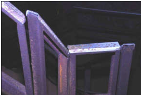
C – Vista de um trecho do guarda-corpo com diversas arestas e pontas cortantes nos corrimãos. Foto: V. Moura.
