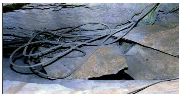
B – Exemplo aparente desorganização do cabeamento elétrico. Local da foto: Salão da Couve-flor. Foto: V. Moura.
