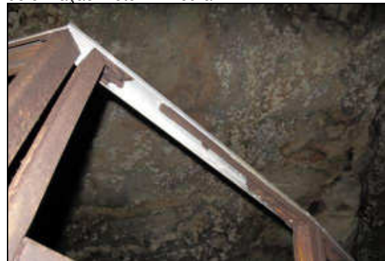
D – Vista do perfil de aço corroído (perfil de cor marrom, na foto), sob o corrimão de alumínio (perfil de cor cinza claro, na foto), apresentando pontas cortantes. Foto: V. Moura.
